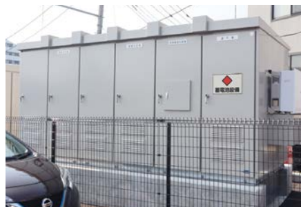
エアコンの電気を担う蓄電装置
