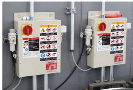
各制御盤には安全スイッチを完備
