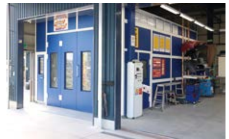
塗装ブースはもちろん完備
