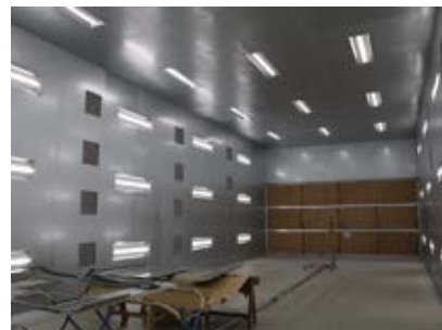
大型車用の塗装ブース
