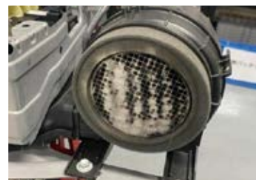
埃が詰まった電動ファン
